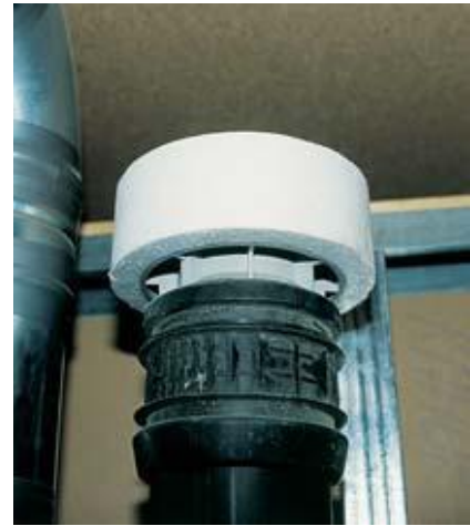
Afb. 21: Ontluchttingsleiding in de installatieschacht
