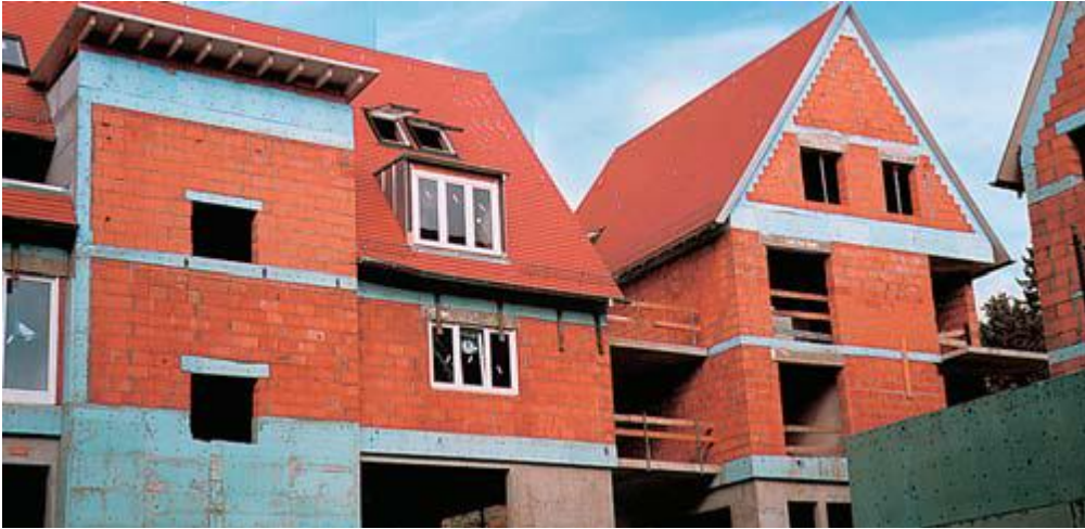
Afb. 17: Verschillende soorten metselwerk met gevaar voor thermische bruggen
