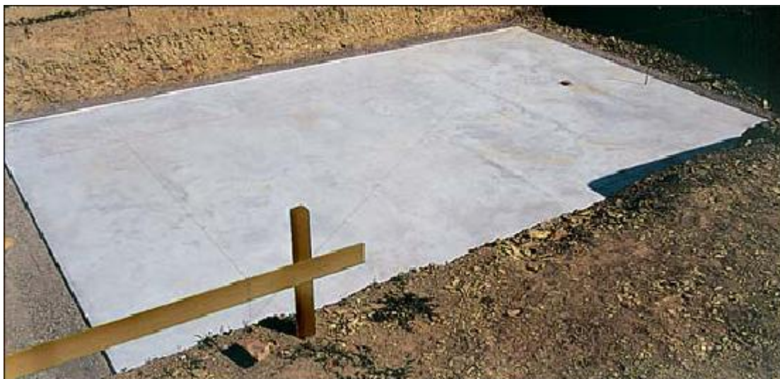
Afb. 2: voorbeeldige bodemplaat; drainage al ingestort
